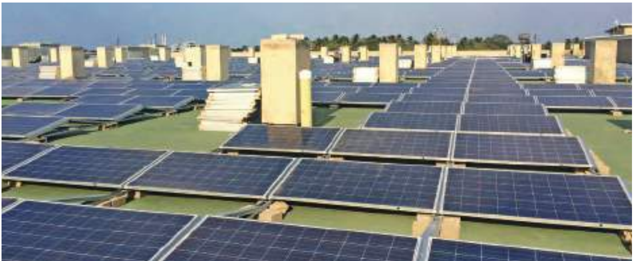
→ 1.596 paneles solares tiene Viva Wajiira instalados en sus 5.000 metros cuadrados de azotea, para aprovechar la luz solar.
